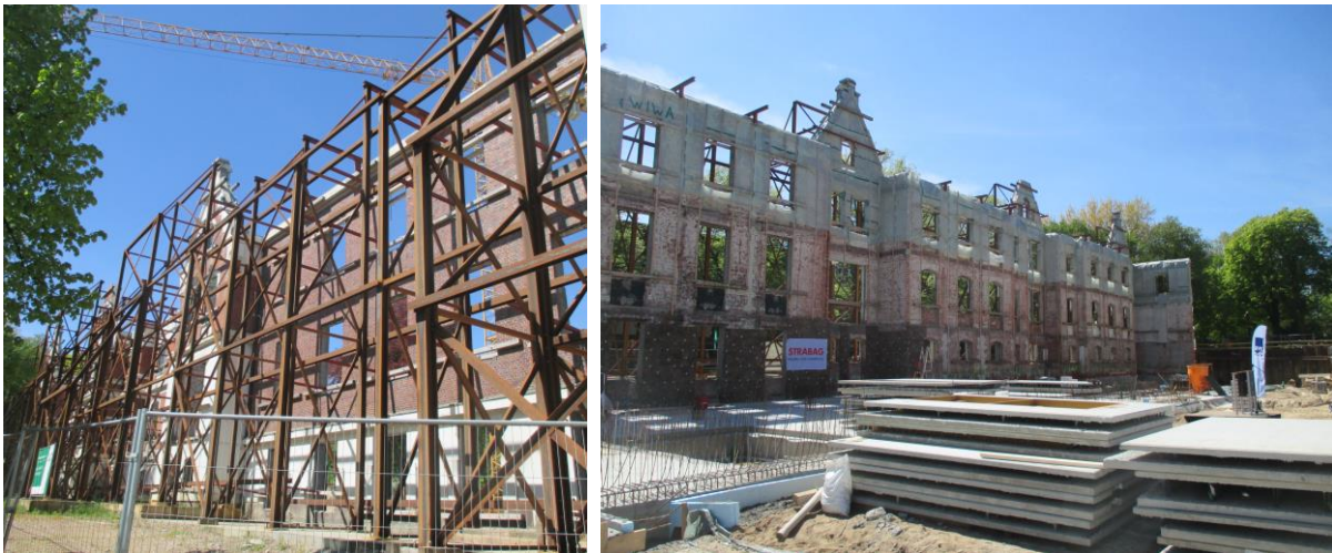
Figure 4 and 5: Fotos der Baustelle bei Grundsteinlegung im Mai 2017 (Fotos: I. M. Reuther).
